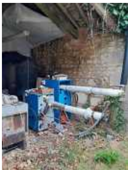
Chaudière au fuel de 2006 et chaudière granulés de fabrication inconnu
