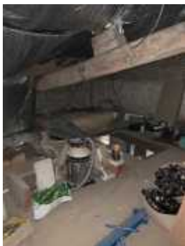
Plancher du grenier 2 non isolé
