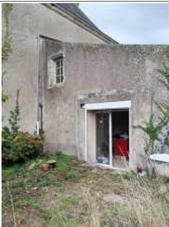
Photo PhDPE007 Ouvrage : Façades Nord - Est de la cuisine
