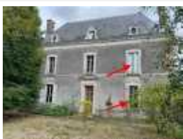
Persiennes métalliques et volets battants en bois en mauvaise état
