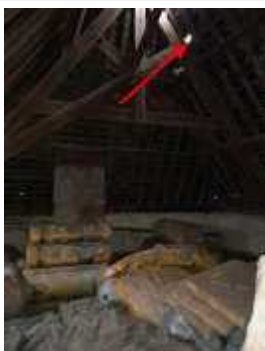
Couverture Ardoises en mauvaise état
