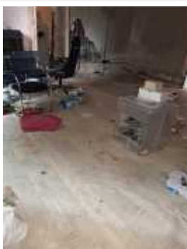
Plancher du rez de chaussée (entrée, bureau, salle à manger, salon, cuisine) de type plancher chauffant
