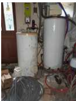
Ballon d'eau chaude en mauvais état
