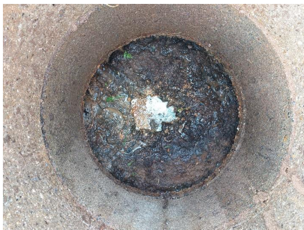
Fosse toutes eaux
