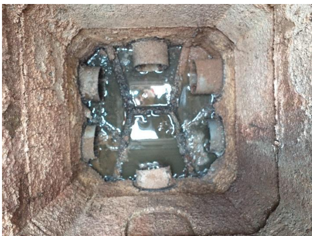
Regard de répartition
