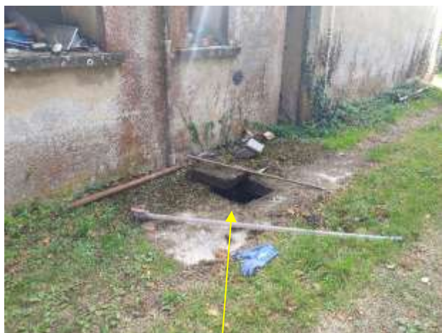
Fosse toutes eaux
